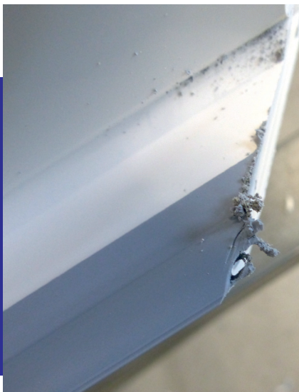
Mangelhaft geschnittene Dichtung.
